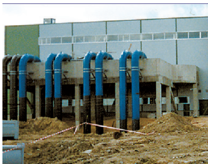
Юго-западные очистные сооружения Санкт-Петербург
