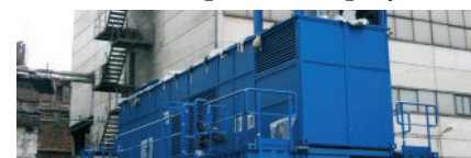
Завод «Звезда Энергетика»
