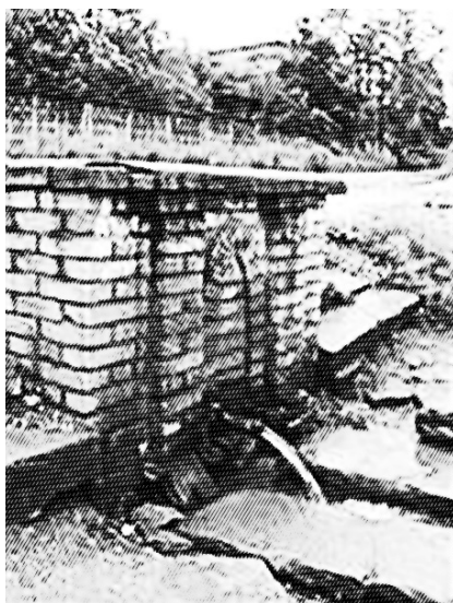
Часть Дудергофской системы водоснабжения
